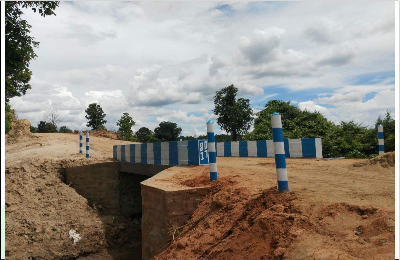
တတိယနှစ်စီမံကိန်းကျေးရွာချင်းဆက်လမ်းပြုပြင်ခြင်း ပြီးစီးမှုမှတ်တမ်းဓာတ်ပုံ
