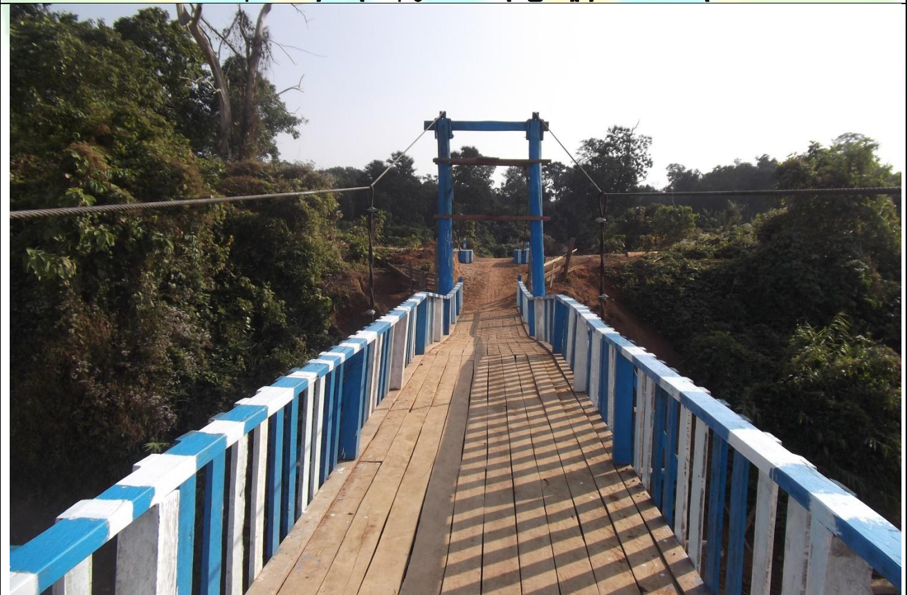
စီမံကိန်း ပထမနှစ် လုပ်ငန်းခွဲဆောက်လုပ်ပြီးစီးမှု မှတ်တမ်းဓာတ်ပုံ
